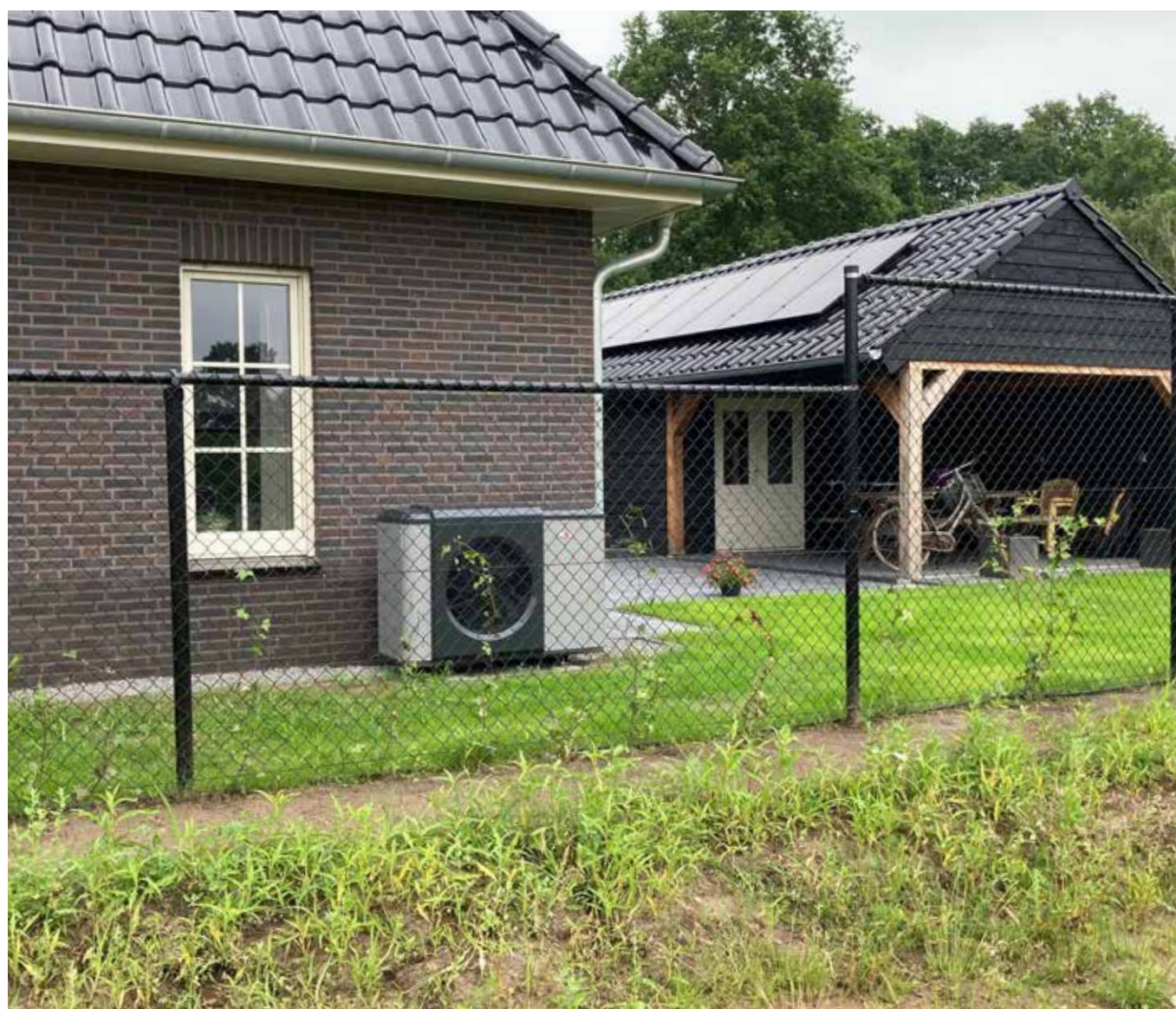
De bewoners waren erg gecharmeerd van het buitendeel van de warmtepomp, die in antraciet is geleverd. Hierdoor sluit het buitendeel naadloos aan bij de donkere gevelsteen van de woning.
