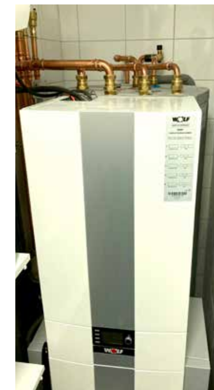
De binnenopstelling betreft een compacte torenopstelling inclusief 280 liter boiler, waarmee in iedere warmtapwaterbehoefte kan worden voorzien.
