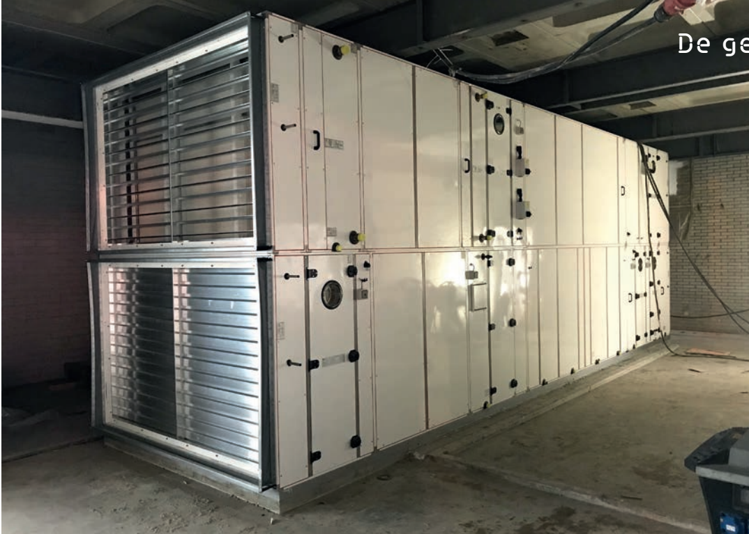
Vier grote luchtbehandelingskasten (Ibk's) van Wolf leveren in Technohal een maximaal debiet van in totaal 90.000 m 3 /h verse buitenlucht.
